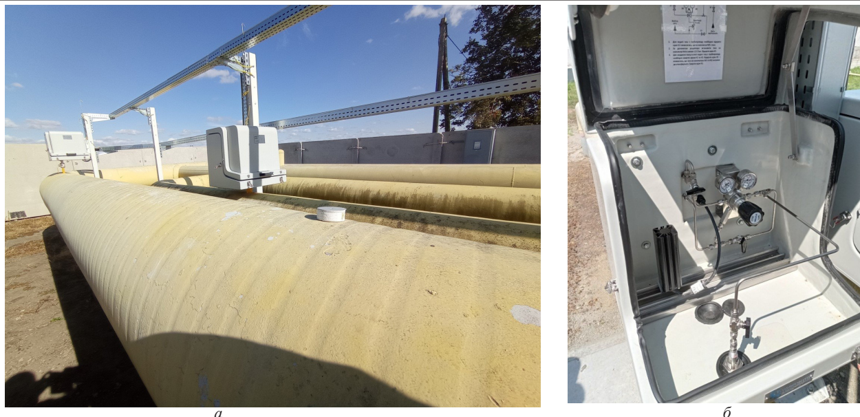
Рис. 4. Встановлені на трубопроводах пристрої відбору представницьких проб природного газу (а), внутрішній вигляд пристрою відбору проб (б)
